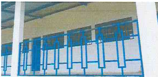
Foto 3: Sustrucción de baranda de metal.
