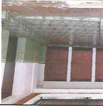
Foto 4: Puertas a sustituir en el modulo de baños.
