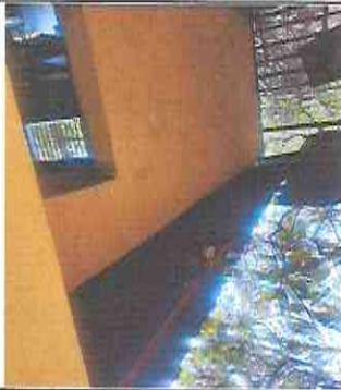
Foto 2: Techo dañado a remover y reinstalar, se amplíara el mismo y con esto amejorar tambien el clima dentro del establecimiento.
