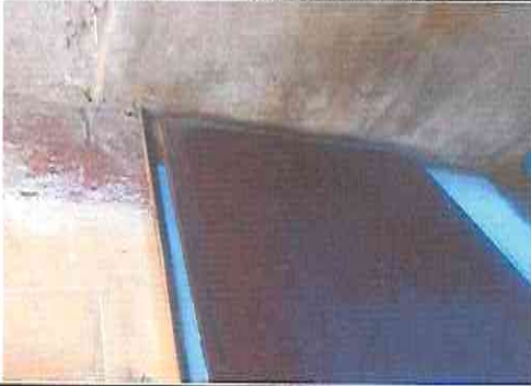
Foto 4: Puertas a sustituir en el modulo de baños.
