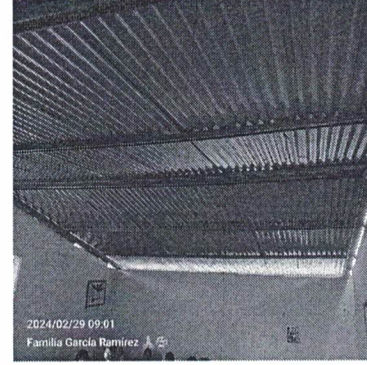
Foto 2: techo dañado a remover y reinstalar, se ampliara la altura del mismo y con esto mejorar también el clima dentro del aula.
