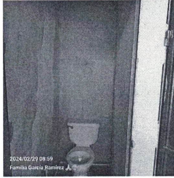
Foto 6: servicios sanitarios dañados y área donde se instalara azulejo.
