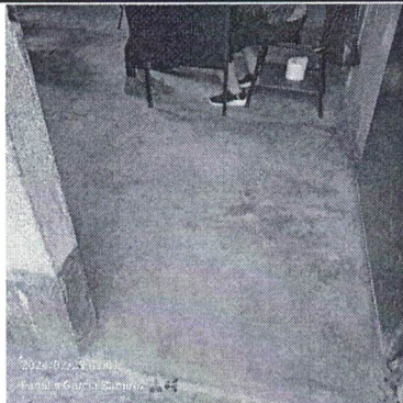
Foto 3: piso existente en aula el cual presenta grietas y daños, se propone la demolición del mismo y la base de concreto mas piso cerámico.
