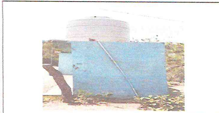
Foto 3: Sustrucción de tubería y accesorios de rotoplas de agua de los baños.
