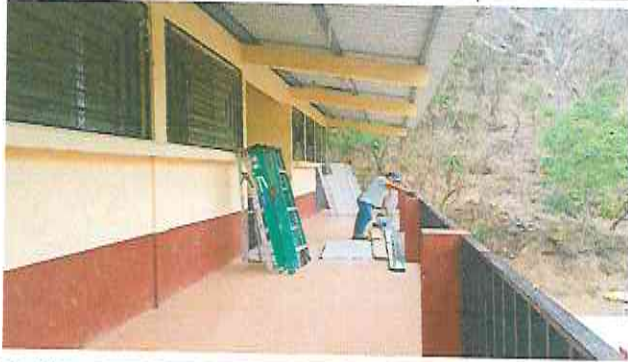
Foto7: Pintura en general de barandales
