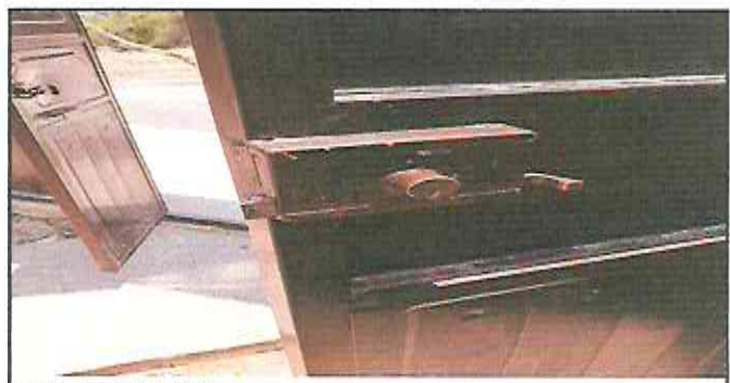
chapa en mal estado.
