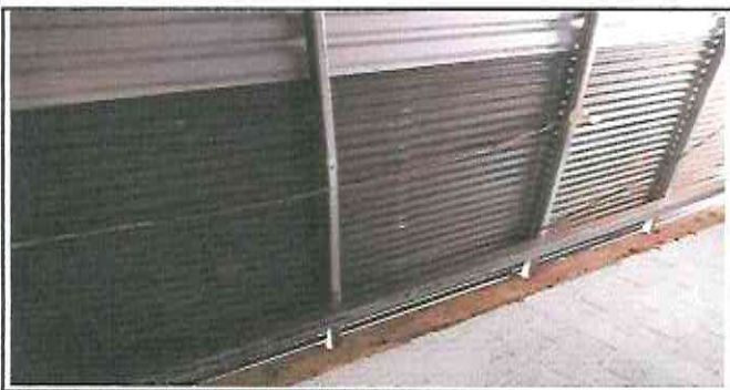
láminas en mal estado, donde filtraba agua.
