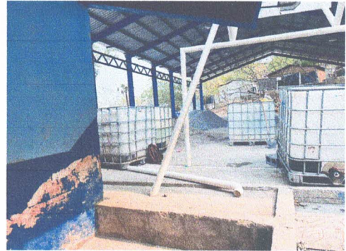
Foto 8: Protección para tubos de bajada pluvial ✓
