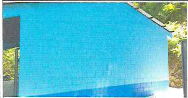
Foto 7: Pintura en muros exteriores e inferiores.
