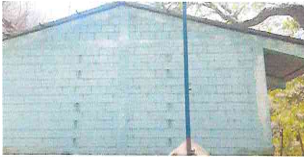
Foto 7: pintura en muros exteriores e inferiores
