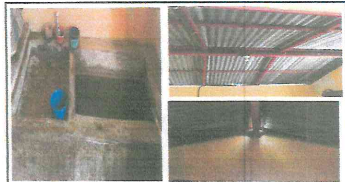
Foto 4: cocina, sustitución de lámina, por lámina troquelada aluzinc caluibre 26 y Sustitución de estructura de soporte de madera por metal, instalación de pila de concreto
