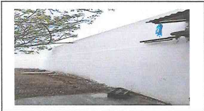
Foto 3: Repello y cernido en tapial área de ingreso a la escuela
