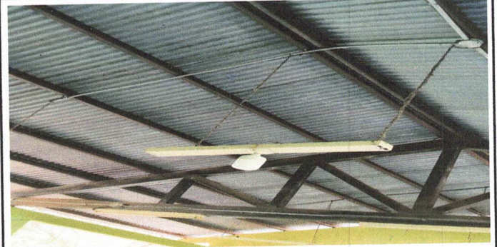
Foto 2: Sustitución de Techo en aulas del segundo nivel con lámina Troquelada calibre 26 legítima
