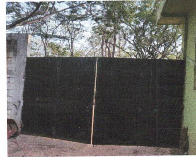
Foto 6: En esta fotografía se aprecia el porton que será Reparado, pintado e instalación
