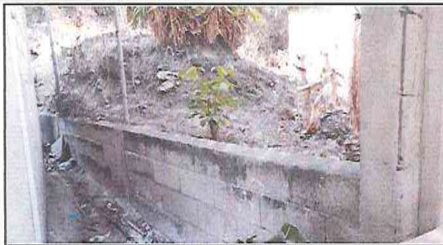
Foto 1: Muro de contención en malas condiciones
