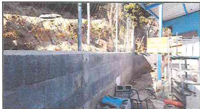
Foto 4: Muro de contención gretado por el desvanecimiento de la tierra que que se desprende constantemente del barranco.
