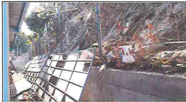
Foto 3: Foto 2: Muro de contención soterrado por la tierra que se desvanece del barranco, estando a punto de colapsar y soterrar las aulas.
