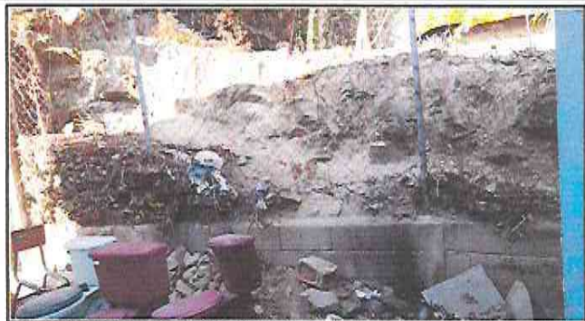
Foto 2: Muro de contención soterrado por la tierra que se desvanece del barranco y a punto de colapsar.
