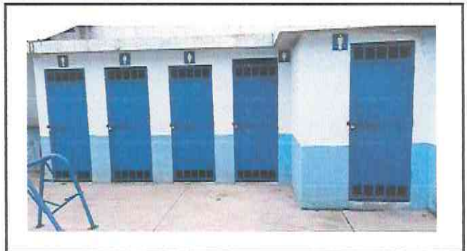
Foto 2: Servicios sanitarios funcionando correctamente.
