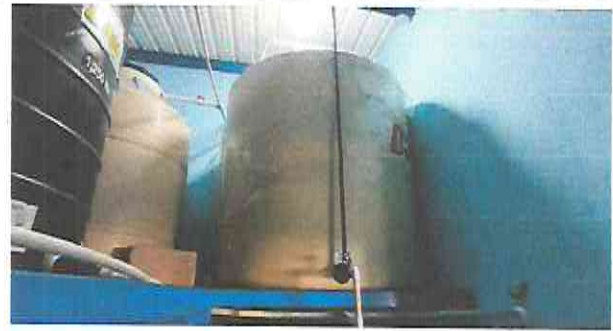
Foto 4: Depósito de agua funcionando.
