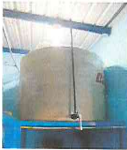
Foto 3: Depósito de agua instalado
