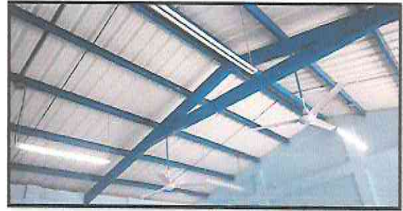
FOTO 2: Sustitución de plafonera y bombillas led, en todas las aulas, bodega, y baños, no dan luz, y el material existentes es de muy baja calidad.
