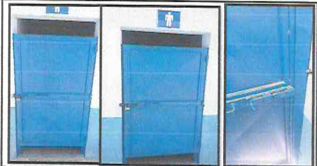
FOTO 6: Reparación de puertas (agregarle arriba y abajo tipo rejillas) y pasadores interiores. Debido a que entran por la parte de abajo y arriba, los que llegan a jugar a la cancha.
