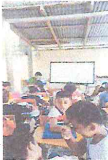
Foto 15: Sustitución de estructura de soporte de metal en galera que sirve como aula.
