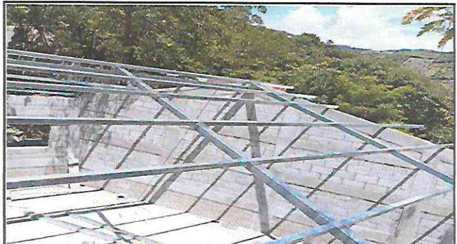
Foto 2: Sustrucción de estructura de soporte de madera, por metal en el aula.
