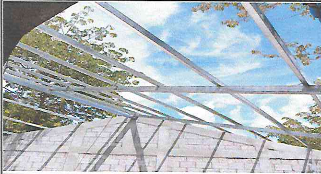
Foto 1: Sustrucción de estructura de soporte de madera, por metal en el aula.
