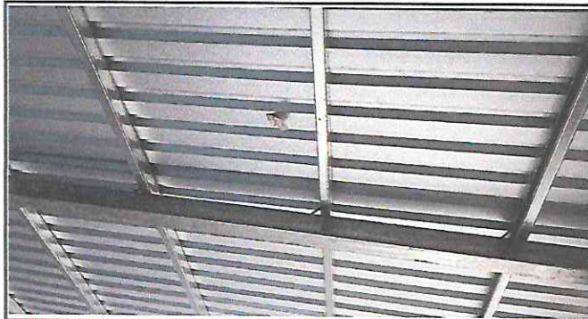
Foto 1: Sustitución de lámina por lámina troquelada aluzinc calibre 26 con tornillera de fijación, en el aula.
