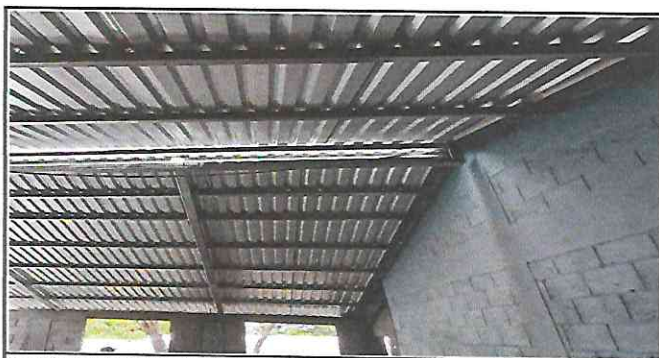
Foto 5: Sustitución de lámina por lámina troquelada aluzinc calibre 26 con tornillera de fijación, en el aula.
