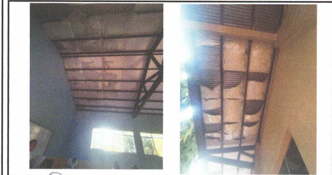
foto No. 1 sustituir lo termico por cielo falso en aulas
