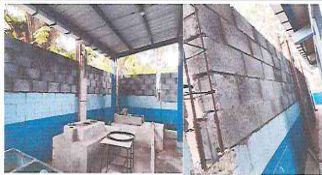
Foto 1: Sustitución de malla por muro de block en área de cocina, el muro abarca parte de atrás de las aulas.
