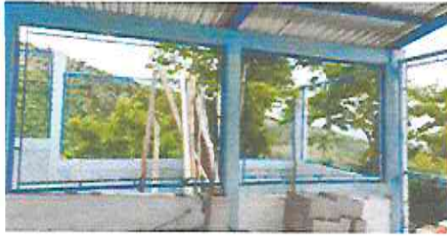
Foto 7: Traslado de balcones de malla para el área de ingreso, serán utilizados los que se quiten de la parte trasera de la cocina, ya que serán sustituidos por block
