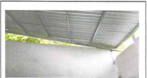
Foto 2: Sustitución de techo en cocina por lamina troquelada y vigas de madera por costaneras.
