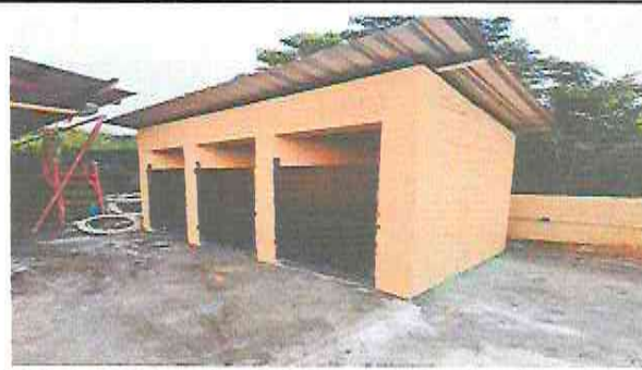
Foto 2:Modulo 2 Mejoramiento de baños, sustitucion de inodoros, mantenimiento puertas, cambio de lamina troqueleada y estructura.
