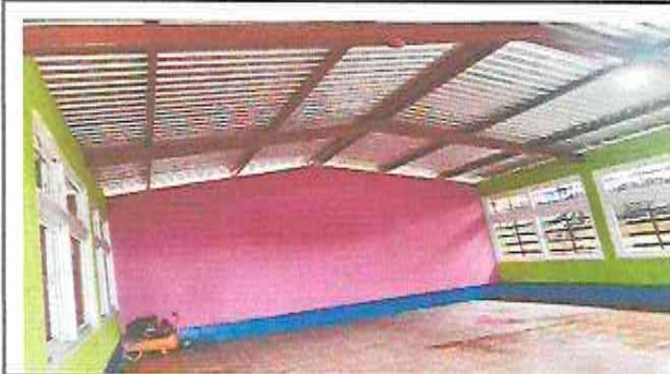
Foto 1: Modulo 1 sustitucion de lamina, por lamina troqueleada alucin calibre 26 y mantenimiento a estructura.
