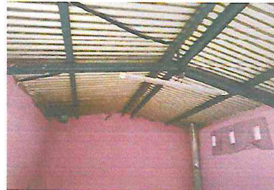
Foto 2: pintura en muros de interiores y exteriores de cocina
