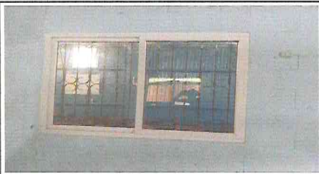
Foto7: Trabajo terminado de abrir vano y colocar ventana de PVC 0.80 X 1.30 mts
