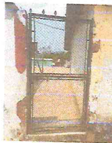
Foto 12: se aprecia el deterioro del porton principal de ingreso al centro educativo
