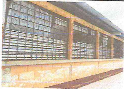
Foto 7: se aprecia el deterioro de los ventanales del centro educativo
