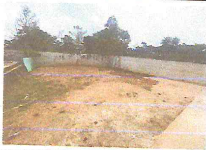
Foto 9: Se aprecia el deterioro de la pintura del muro perimetral
