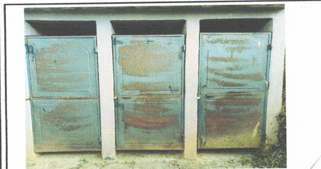
Foto 3: Reparación y pintura de puertas de 6 baños.
