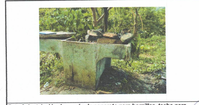
Foto 6: Instalación de mesón de concreto para hornillas, techo para mesón con lamina troquelada.
