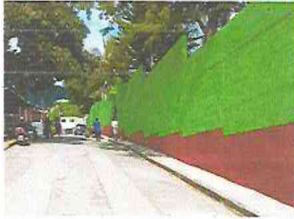
Foto 7: Pintura en muro exterior frente.
