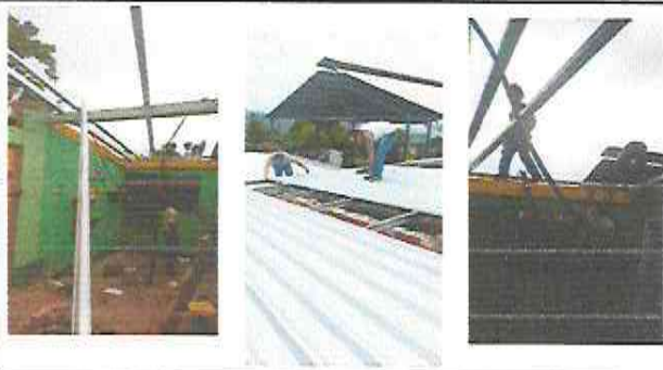
Foto1: Dirección. Levantado sobre muro, sustitución de lamina, sustitución soporte de madera por metal.
