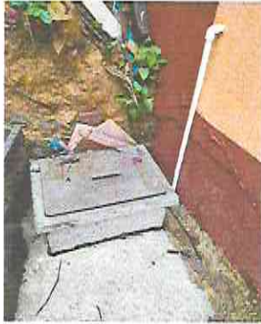
Foto 19: Sustrucción de caja de registro
