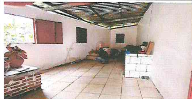
FOTO 6: ALISADO EN MURO
