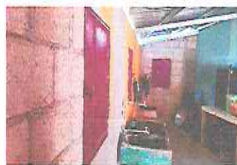
FOTO 6: ALISADO EN MURO
