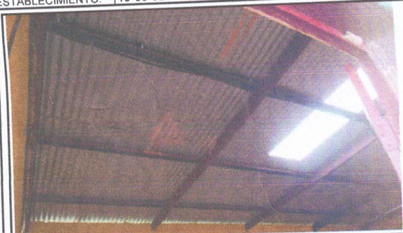
FOTO 1: SUSTITUCIÓN O INSTALACIÓN DE LÁMINA Y MANTENIMIENTO DE ESTRUCTURA DE SOPORTE DE METAL EN AULAS.
