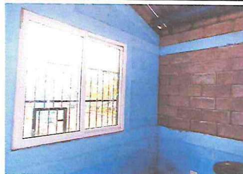
Foto 4: Sellado de ventana en cocina (Se sellara esta ventana)
