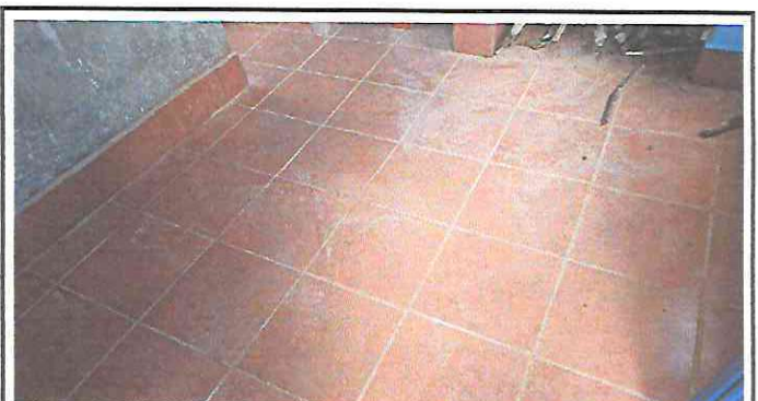
Foto 10: Sustrucción de piso por piso cerámico
