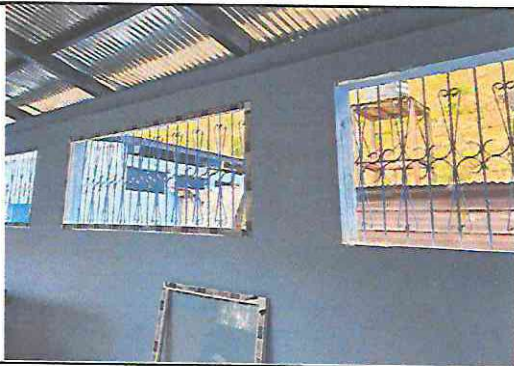
Foto 17: sustitución de ventanas de madera por ventanas PVC 2.40 x 1.00 mantenimiento con pintura a balcones
