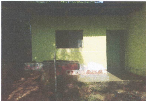
Foto 3: Sustitución de pila movable por pila fija
