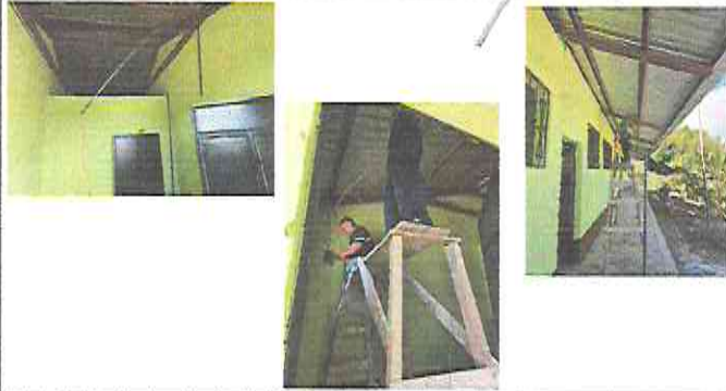
Foto 1. Sustitución de cableado eléctrico, Sustitución de lámparas tipo LED de LISTÓN, Sustitución de interruptores simples (incluye instalación de canaletas), Sustitución de tomacorrientes dobles, Sustitución tablero de fitones, Sustitución de ducto eléctrico + accesorios
