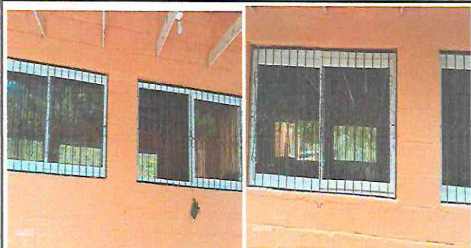
Foto 1: INSTALACIÓN DE VENTANAS PVC CORREDIZAS, MANTENIMIENTO DE BALCONES. (LIJADO Y PINTADO) AULA MODULO 1
