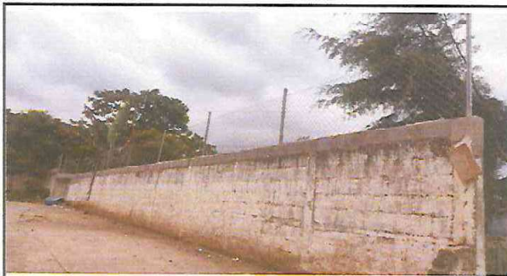
2.1. INSTALACION DE SOLERA TUBERIA METALICA Y MAYA CICLONICA PARA MURO PERIMETRAL PARTE FRONTAL.
