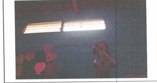
Foto 4: Ventanas con poca iluminación en mal estado
