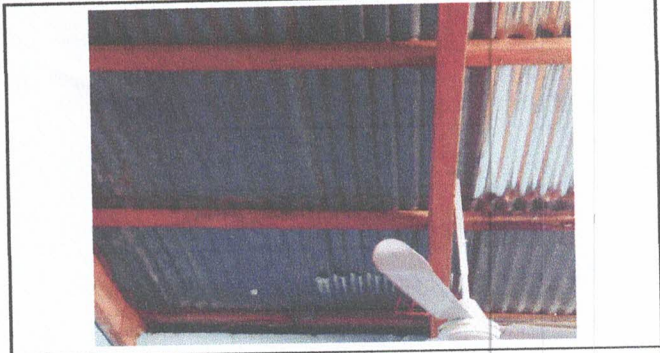
Foto 2: Lámina oxidada por tiempo de uso
