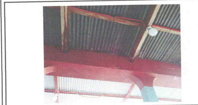
Foto 3: Estructura de madera de techo en mal estado
