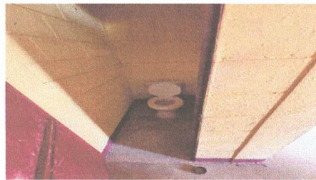
FOTO 2: SUSTITUCION DE ACCESORIOS EN INODOROS ( CONTRA LLAVE, TUBO DE ABASTO Y TANQUE) ✓
