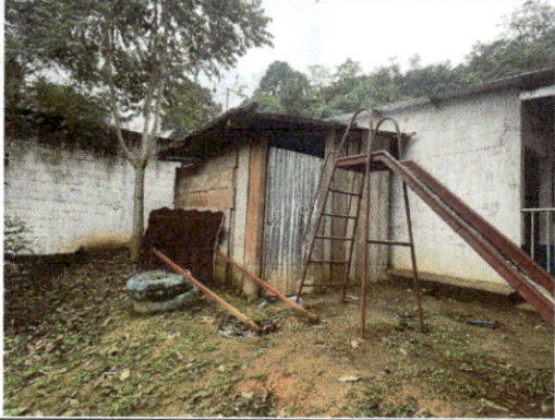
Foto 1: Módulo A, cocina en mal estado
