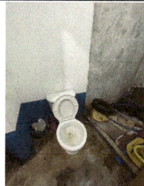
Foto 6: Módulo C, sanitario en mal estado
