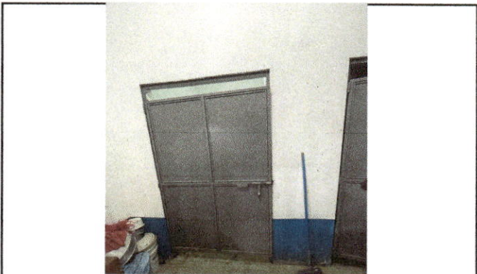
Foto 10: Módulo C, Puertas con pintura deteriorada
