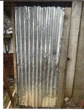
Foto 2: Módulo A, puerta de cocina en mal estado
