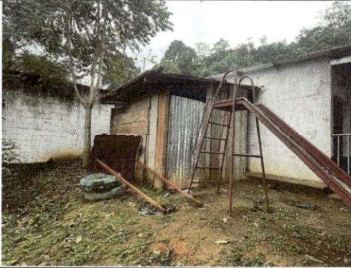
Foto 1: Módulo A, cocina en mal estado
