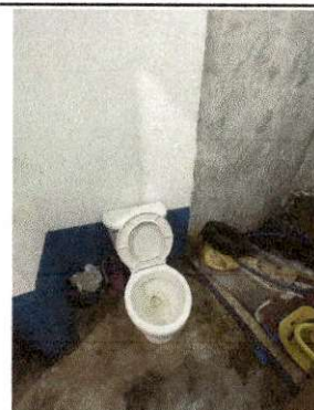
Foto 6: Módulo C, sanitario en mal estado
