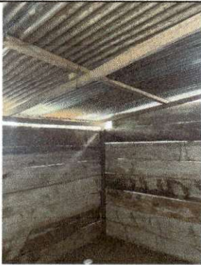
Foto 3: Módulo A, techo de cocina en mal estado
