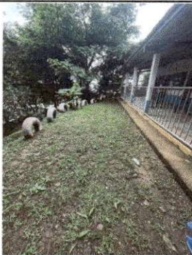
Foto 5: Módulo B, área donde se empoza el agua
