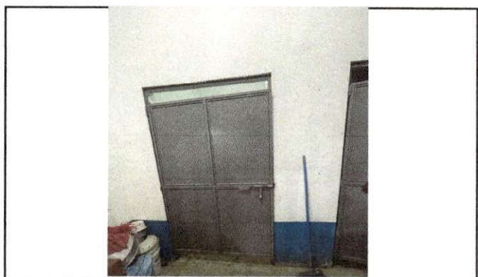
Foto 10: Módulo C, Puertas con pintura deteriorada
