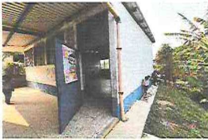
FOTO 3: Mantenimiento a estructura a puertas Y cambio de chapa (lijado, cambio de tubo, cepillado, sujeciones, aplicación de pintura)
