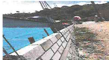
FOTO 6: Reparación de muro perimetral de block TIPO 2 con tubo hg y malla galvanizada, soleras intermedias y columnas
