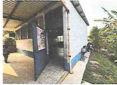
FOTO 4: Sustrucción de soporte o pescante de metal para canal Y SUSTITUCION DE CANAL DE PVC
