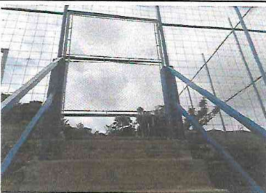
Foto 1.2 Puerta con maya metalica de 2*1
