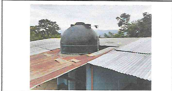
Foto 4.3 Instalacion de Tinaco existente con accesorios
