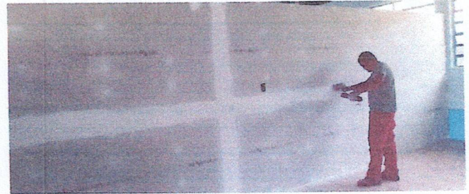
Foto 4: Reparacion Aulas, cocina, corredor y Bodega. (División de 2 Aulas, para 4 aulas con Tabique de tablayeso ambas caras).
