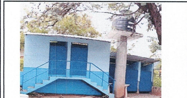
Foto 3: Reparación de Servicios Sanitarios: Sustitución de barandal, cambio de techo, mantenimiento de puertas, sustitución de inodoros, Pintura en interiores y exteriores
